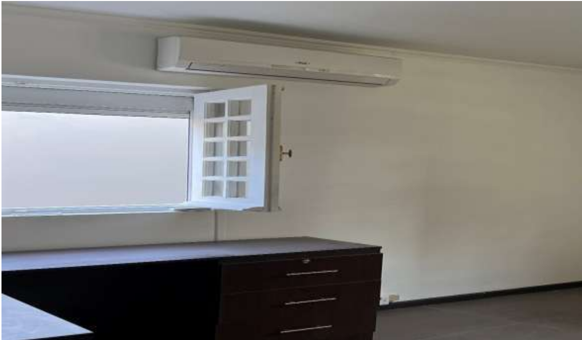
Figura N°10: Sistema de climatización frío/calor instalado en todas las oficinas del primer piso. Fotografía: Cristian Prado Valenzuela.
