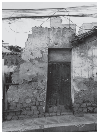
Figura 2. Deterioro del Patrimonio Inmueble próximo en el sector de la calle Linares Foto propia
