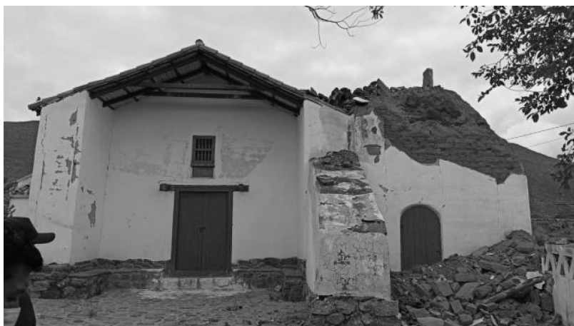
Figura 3. Colapso parcial de la torre de la capilla (fotografía de la autora)
