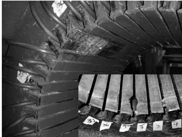
Fig. 3: Daños visibles por soldadura de chapas Cortocircuito entre bobinas y chapas en el interior de la ranura
